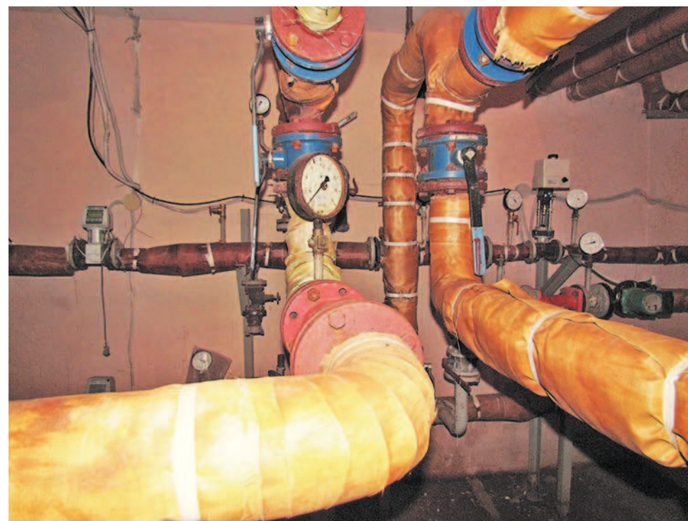
Теплоузел работает, как часы
