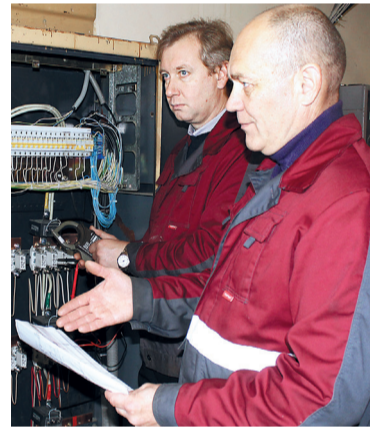
Руководитель электротехнической службы Н. Артемьев (первый справа) и инженер Д. Перминов готовят дом к замене электрооборудования.
