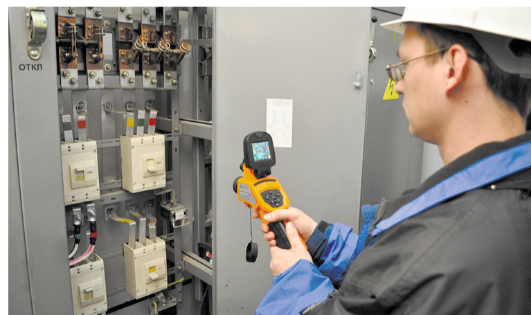
Проверка электрооборудования тепловизором.
