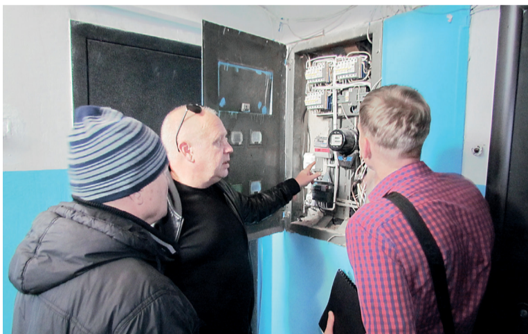
Заместитель главного инженера Управдома Заволжского района А.А. Смирнов принимает капитальный ремонт электрооборудования в подвезде
